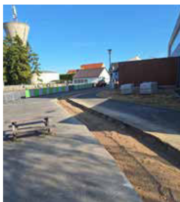
Tassement de la tranchée avant l'implantation du nouveau grillage
