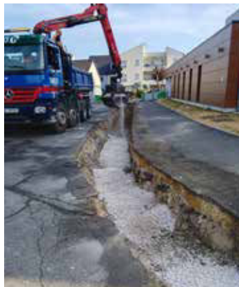
Drainage des sous-sols
